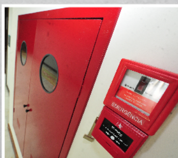
▶ Alarmes contra incêndios.
